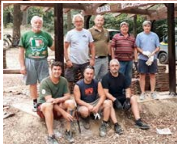
Ristrutturazione della tettoia del Parco del Roccolone ad opera degli splendidi volontari del Gruppo Alpini, con il supporto logistico degli operai comunali.
