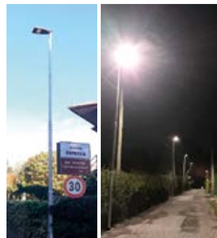
Nuovi lampioni in Via Derocca (zona SUD di Cascine)
